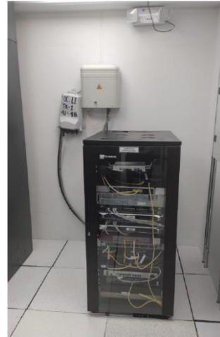
Imagen N° 03: Gabinete de Comunicaciones
