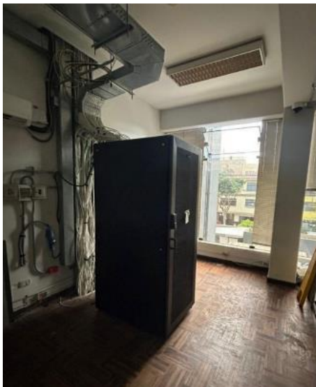
Imagen N° 04: Sala de Comunicaciones
