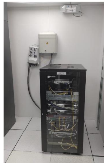
Imagen N° 05: Gabinete de Comunicaciones
