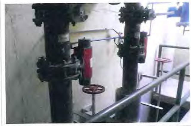
Fig. 20 Sistema de Purgas entrada al Decantador B
