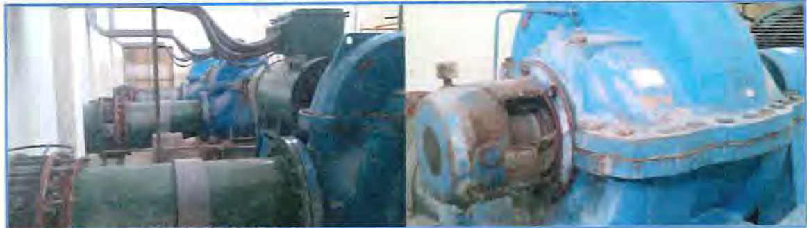
Fig. 42 Electrobombas de agua tipo Caracol (A, B y C)
