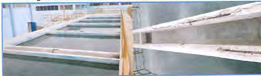
Fig. 24 Canaletas de recolección de agua decantada en mal estado
