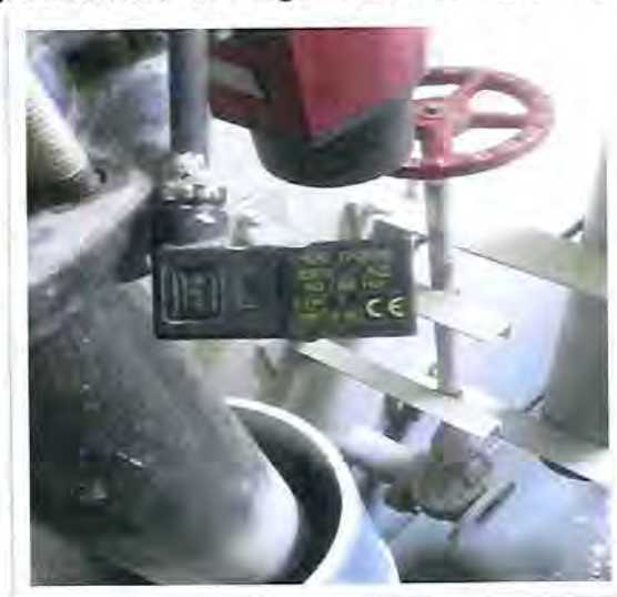
Fig. 21 Sistema de Purgas Salida del Decantador B
