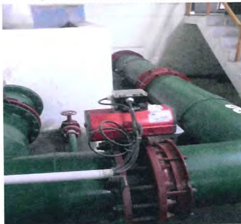
Fig. 28 Electroválvula de accionamiento Filtros
