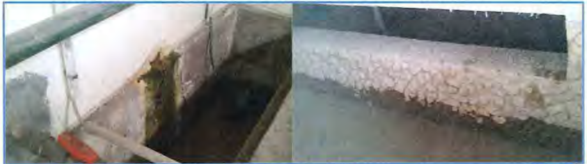
Fig. 39 Tanques de Almacenamiento de Sulfato de Aluminio Granular
