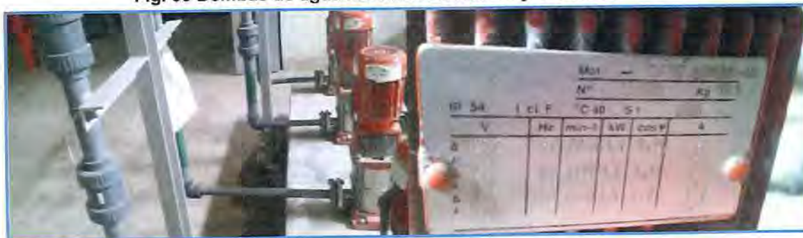
Fig. 50 Bombas de agua motriz Precloración y Cloración
