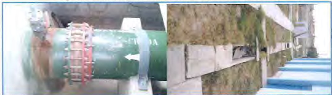
Fig. 15 Punto de aplicación de Cloro como Pretratamiento
