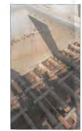
Formación de lodos fuera de la cámara de extracción de lodos (ver huella)
