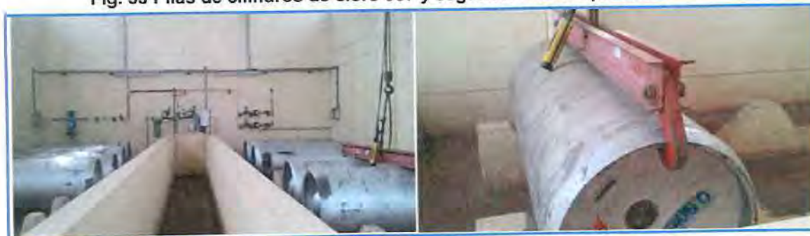
Fig. 53 Pilas de cilindros de cloro 907 y seguridad en su aplicación
