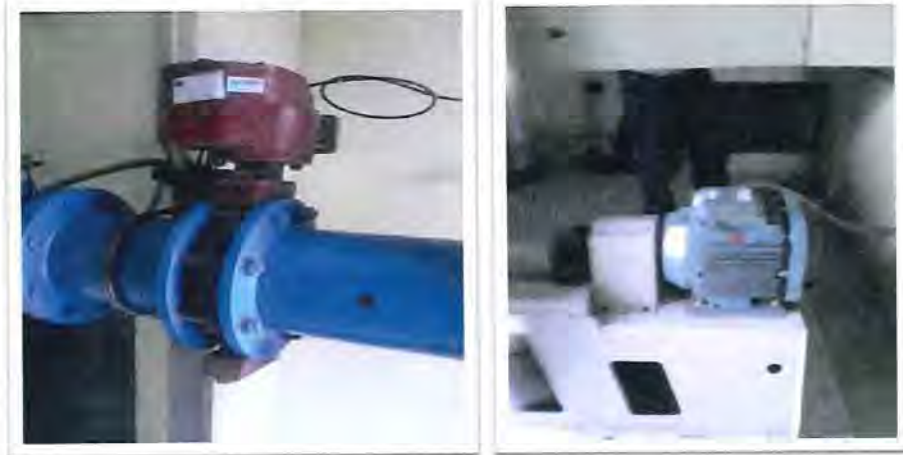
Fig. 16 Sistema de Pulsaciones Decantador A
