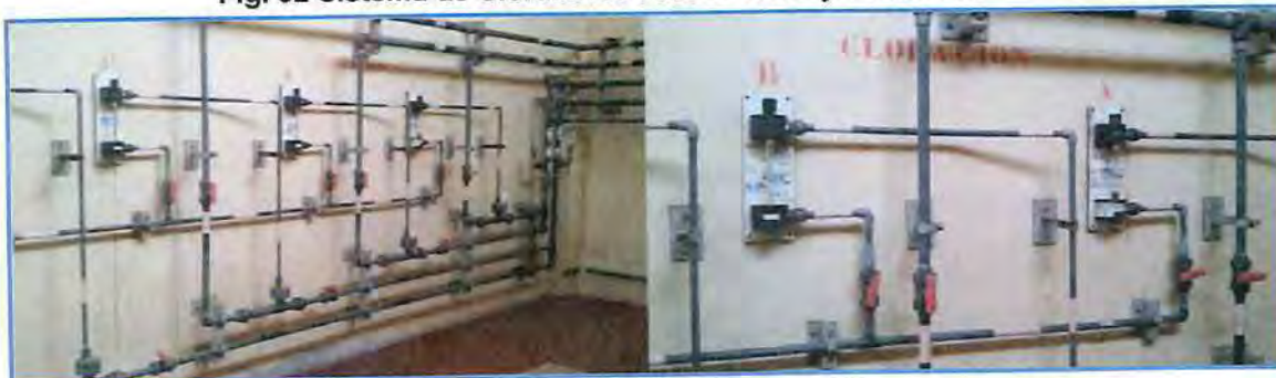
Fig. 52 Sistema de Cloradores Precloración y Cloración
