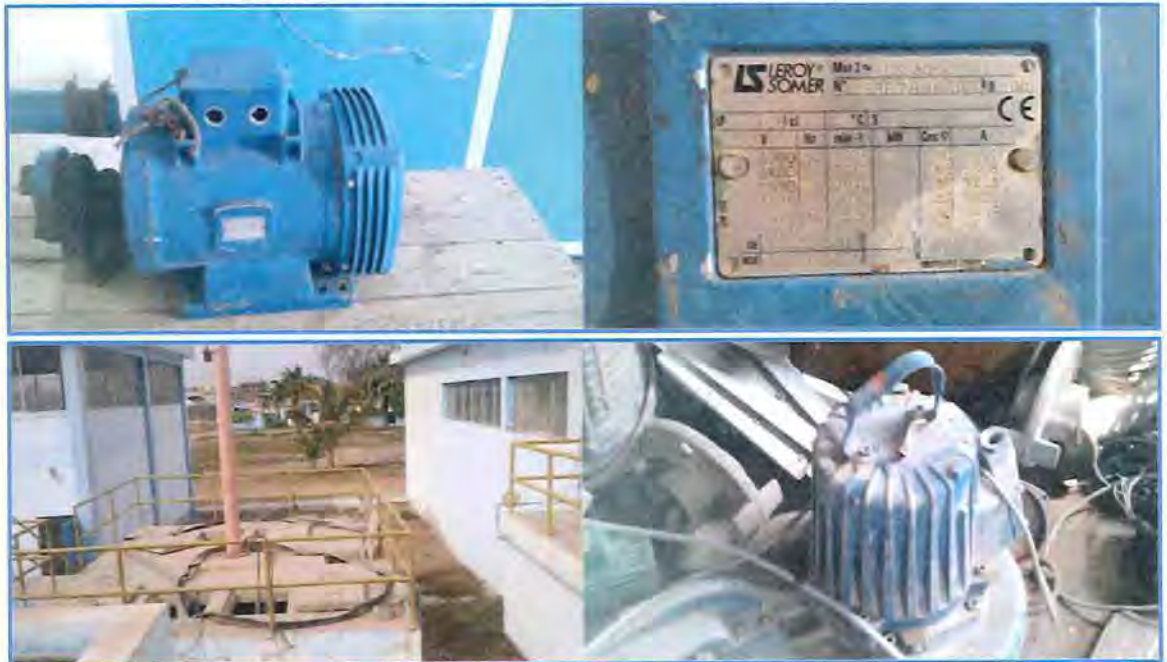
Fig. 41 Bombas Sumergibles de lodos y lavado de filtros
