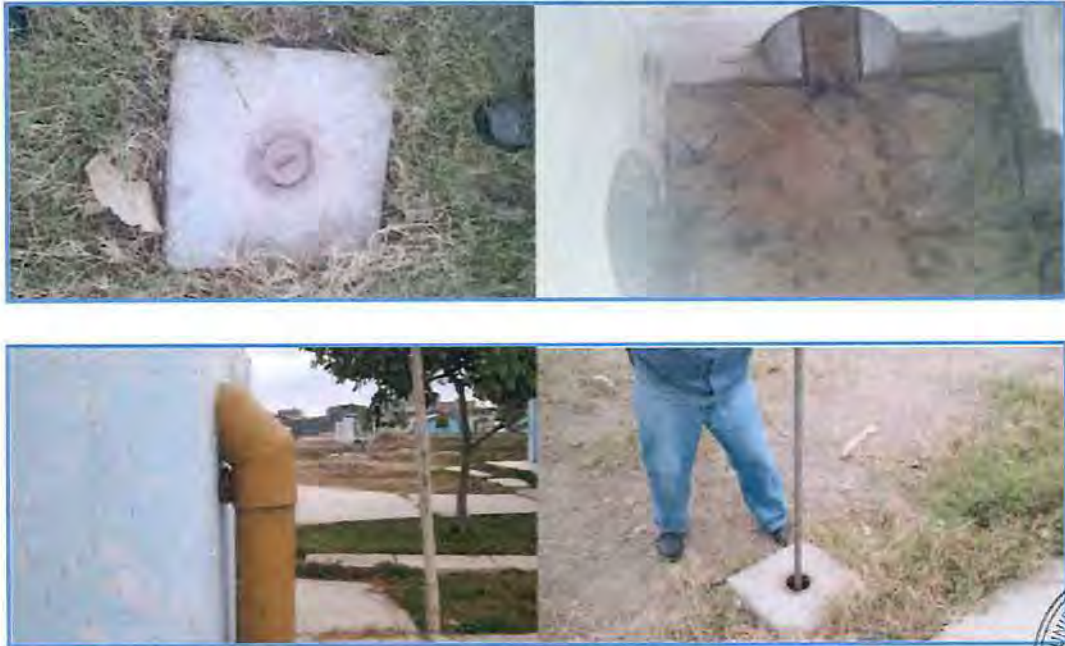
Fig. 12 No operatividad del sistema de purga de tubería de alimentación de agua cruda
