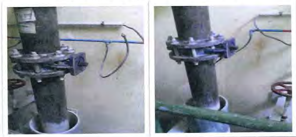
Fig. 18 Sistema de Purgas salida del Decantador A
