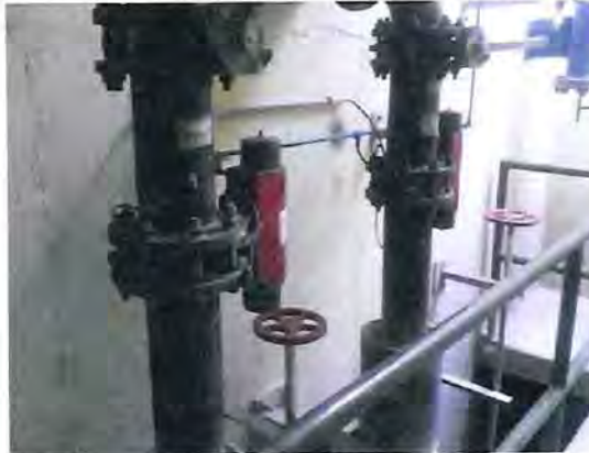
Fig. 17 Sistema de Purgas entrada al Decantador A
