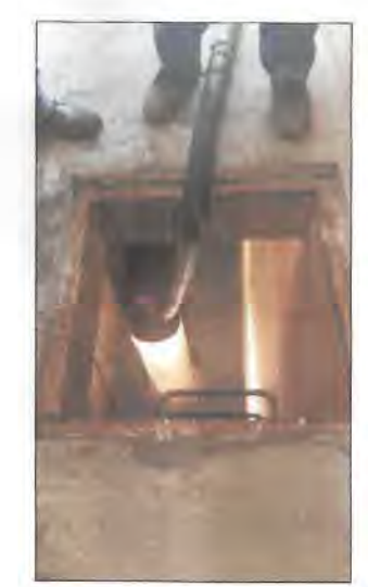
Ingreso de agua a campana de vacío
