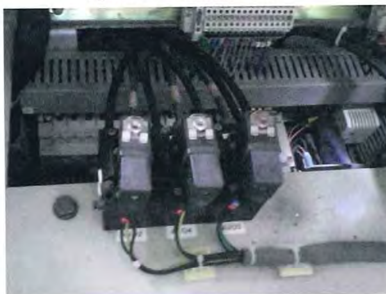
Fig. 29 Cambio de conectores M10
