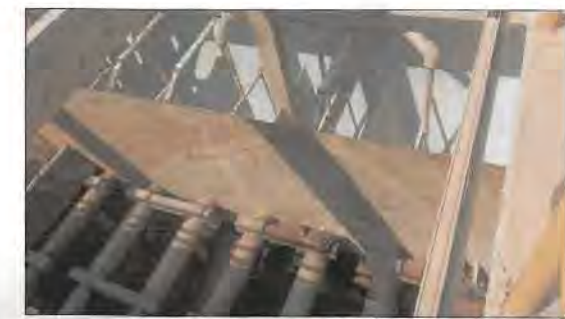
Huella de la acumulación de lodo
