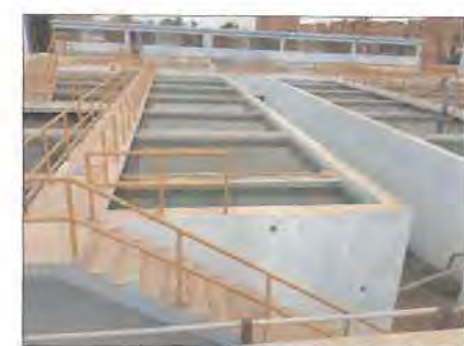
Canaletas de recolección deterioradas
