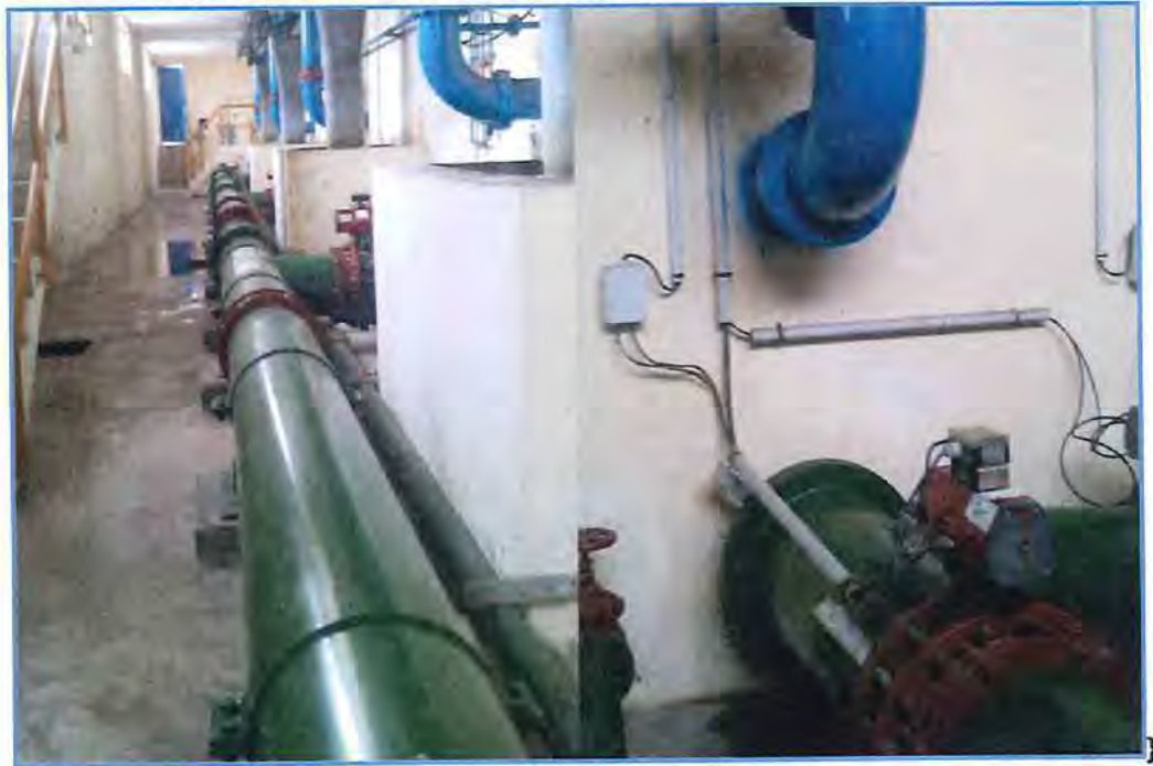
Fig. 49 Aplicación de cloro en Cloración, salida de filtros A – F
