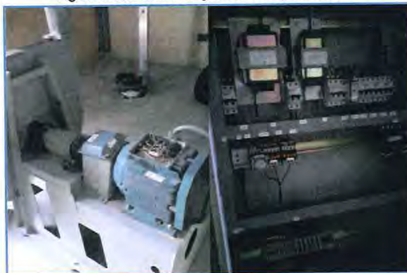
Fig. 23 Motor eléctrico y tablero de pulsaciones
