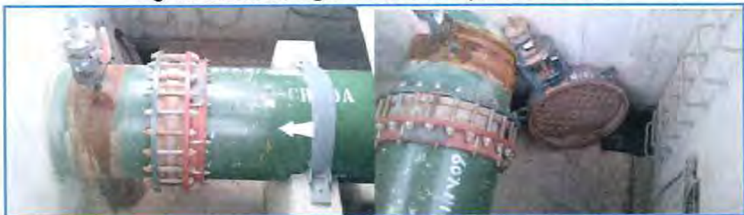
Fig. 13 Tubería de ingreso a obra de reparto de la Planta
