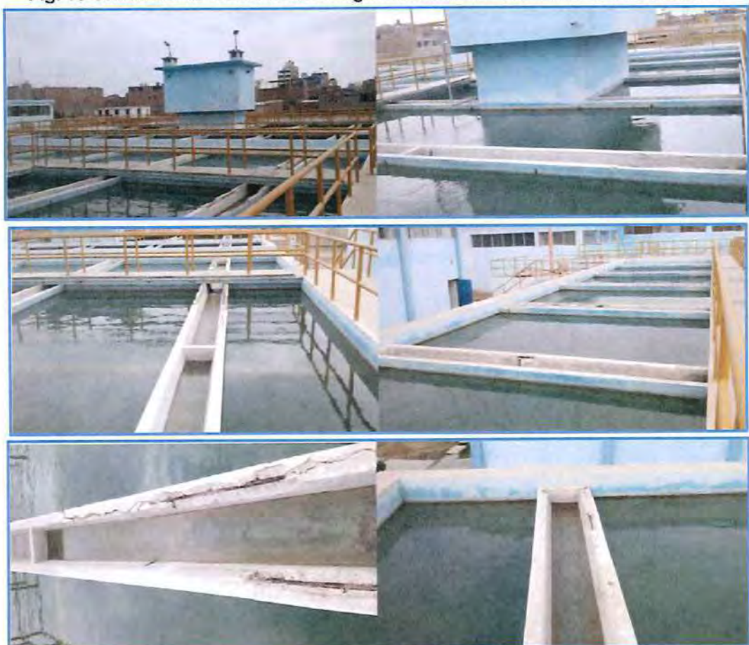
Fig. 15 Canaletas de recolección de agua decantada e infraestructura hidráulica
