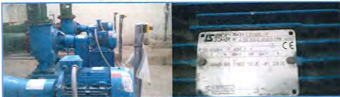
Fig. 40 Bombas Centrífugas (A,B y C)
