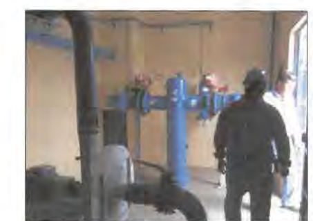
Campana de Vacío inoperativa
